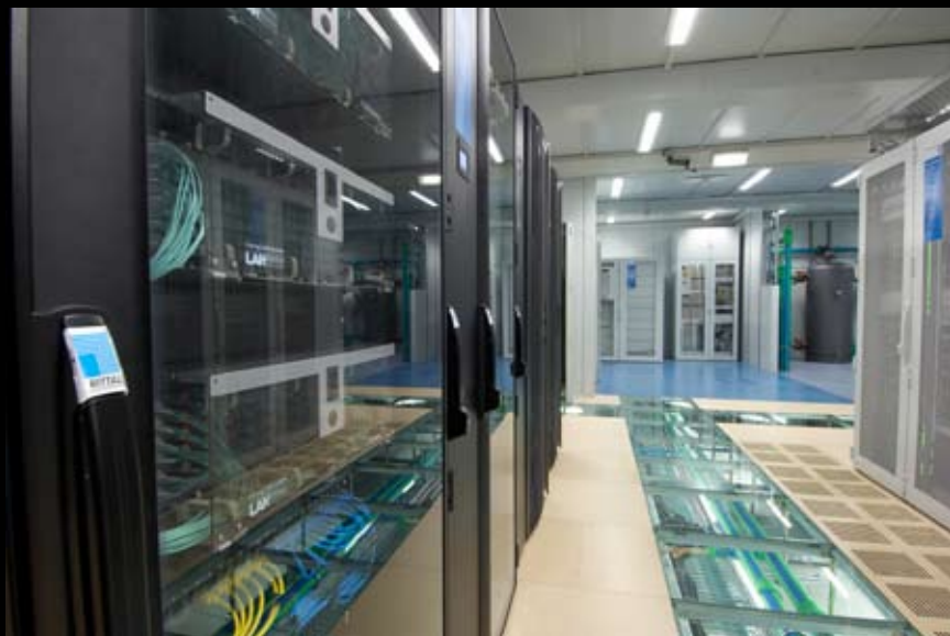
Охлаждение посредством LCP (Liquid Cooling Package). Фрагмент экспозиции на выставке CeBIT 2010
